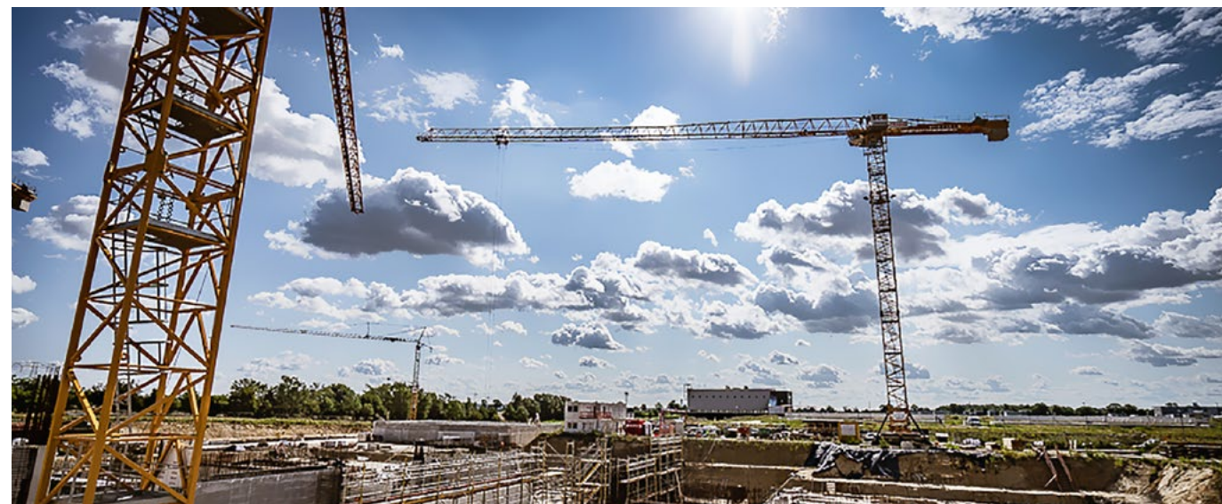
Das Klärwerk Waßmannsdorf ist das derzeit größte Investitionsprojekt der Berliner Wasserbetriebe. Der neu gebaute Mischwasserspeicher ist seit 2019 in Betrieb.
