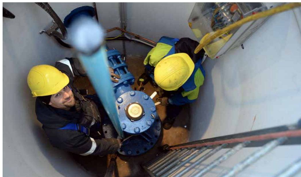
ENERWAG – Energieeinsparung in der Brunnen-Rohwassergewinnung
